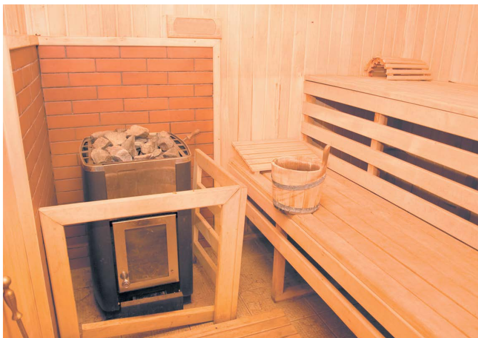
Рис. 20. Парилка с установленной электрокаменкой
