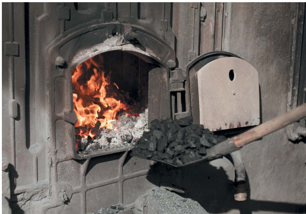
Рис. 34. Котел на угле
